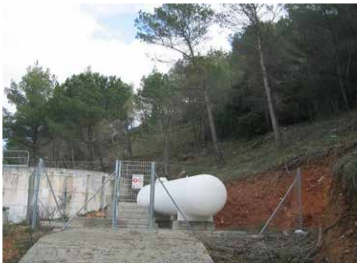
Imatge 4: Instal·lació de gas amb zona de protecció. Font: DGF
