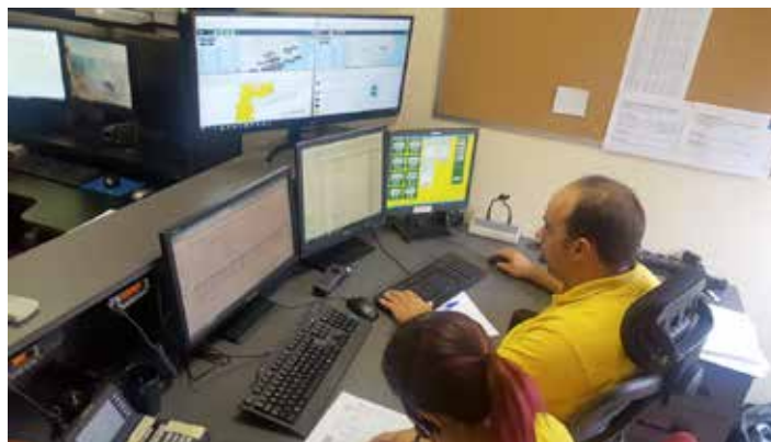
Imatge 7: Sala de Control Torreferrussa. Font: SFADF
